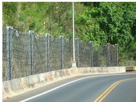
图 3-22 被动防护网防护
