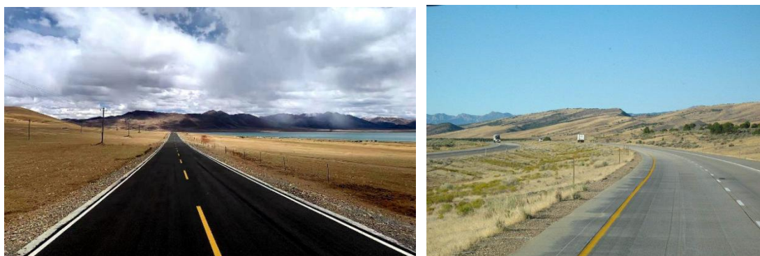
图 3-20 裸露边坡实例
