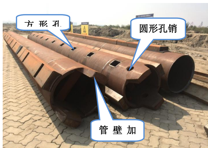
图 5.1-20 加翼接头管接头加固
