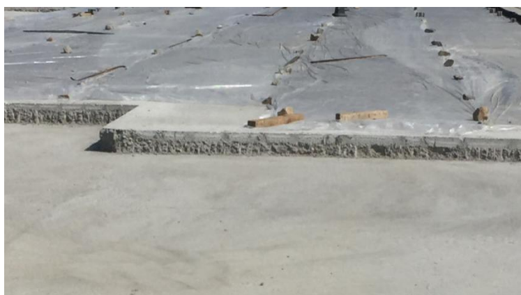
图 2.3-11 水泥稳定层施工缝
